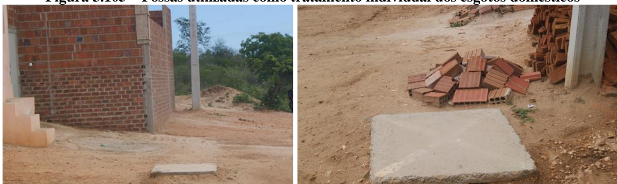
Figura 3.105 – Fossas utilizadas como tratamento individual dos esgotos domésticos
