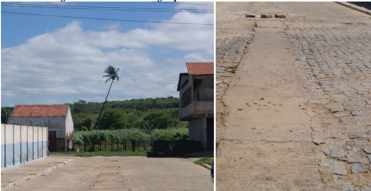
Figura 3.124 – Galeria de água pluvial na zona urbana de Livramento
