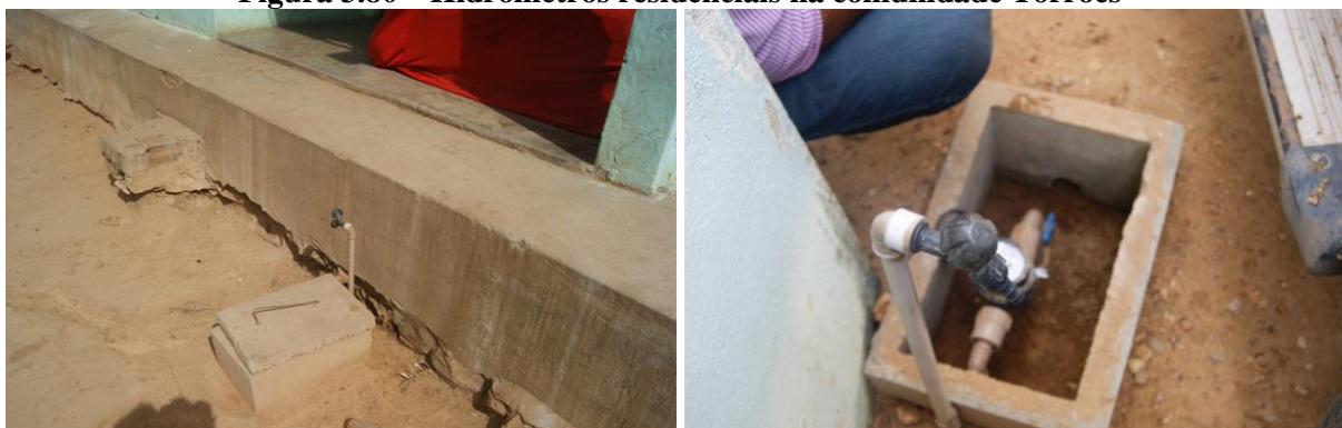
Figura 3.80 – Hidrômetros residenciais na comunidade Torrões
