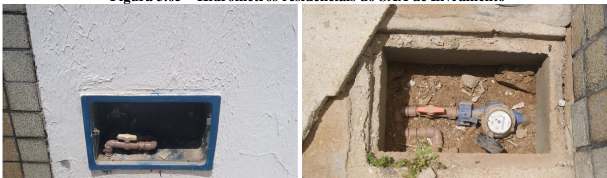
Figura 3.65 – Hidrômetros residenciais do SAA de Livramento
