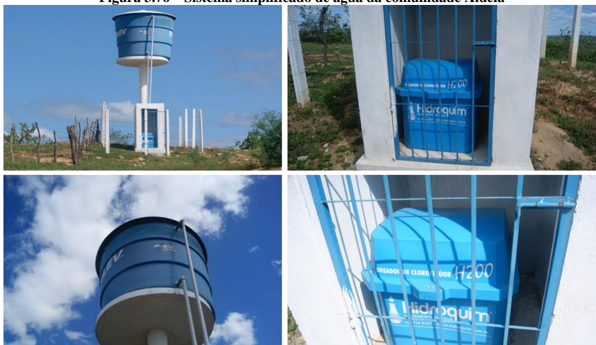
Figura 3.76 – Sistema simplificado de água da comunidade Aldeia
