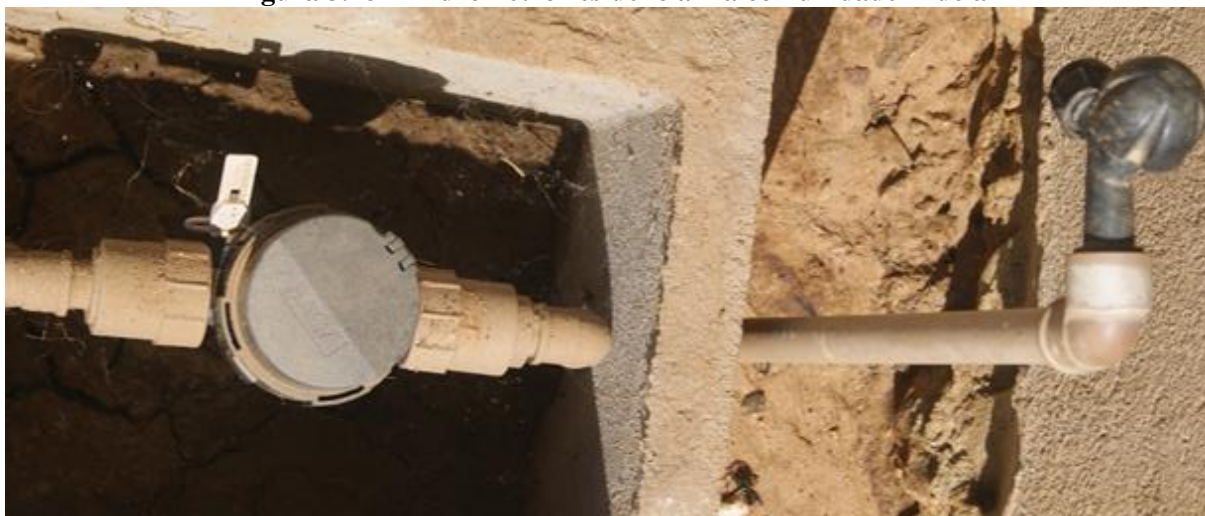
Figura 3.78 – Hidrômetro residencial na comunidade Aldeia
